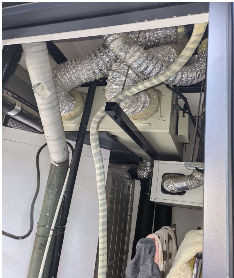
图 4-1 本项目安装的活性炭净化装置
