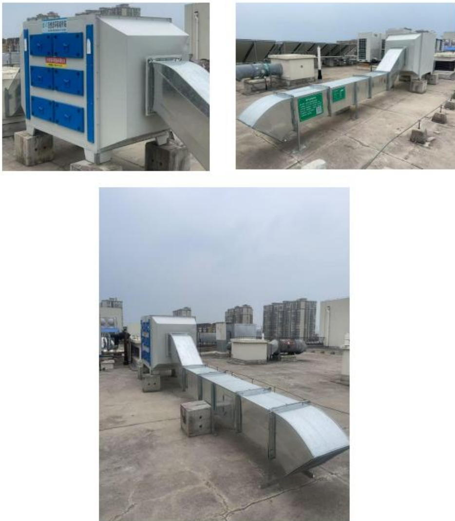
图 2-5 煎药室废气治理措施
