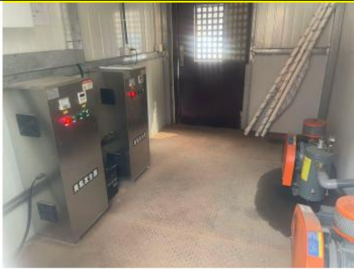
图 2-7 污水设备操作间内部照片
