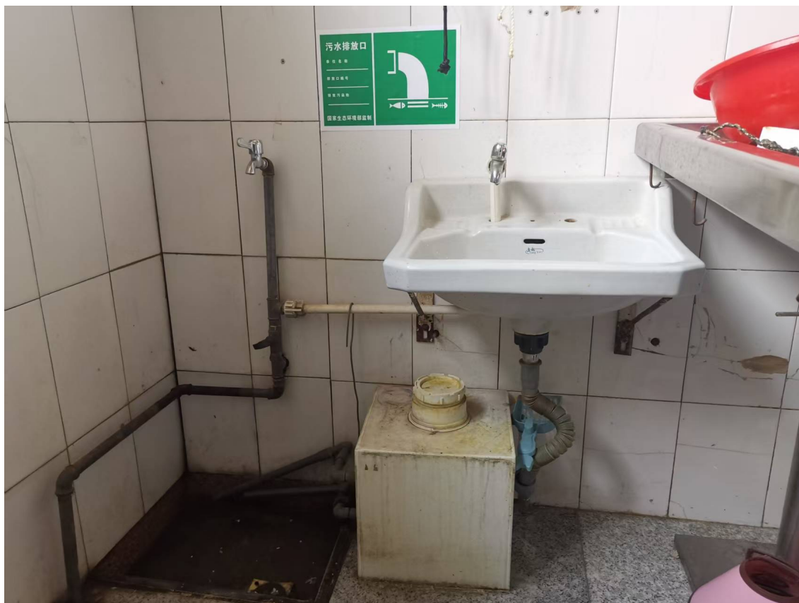
图4-2 本项目医疗废水处理设施情况
