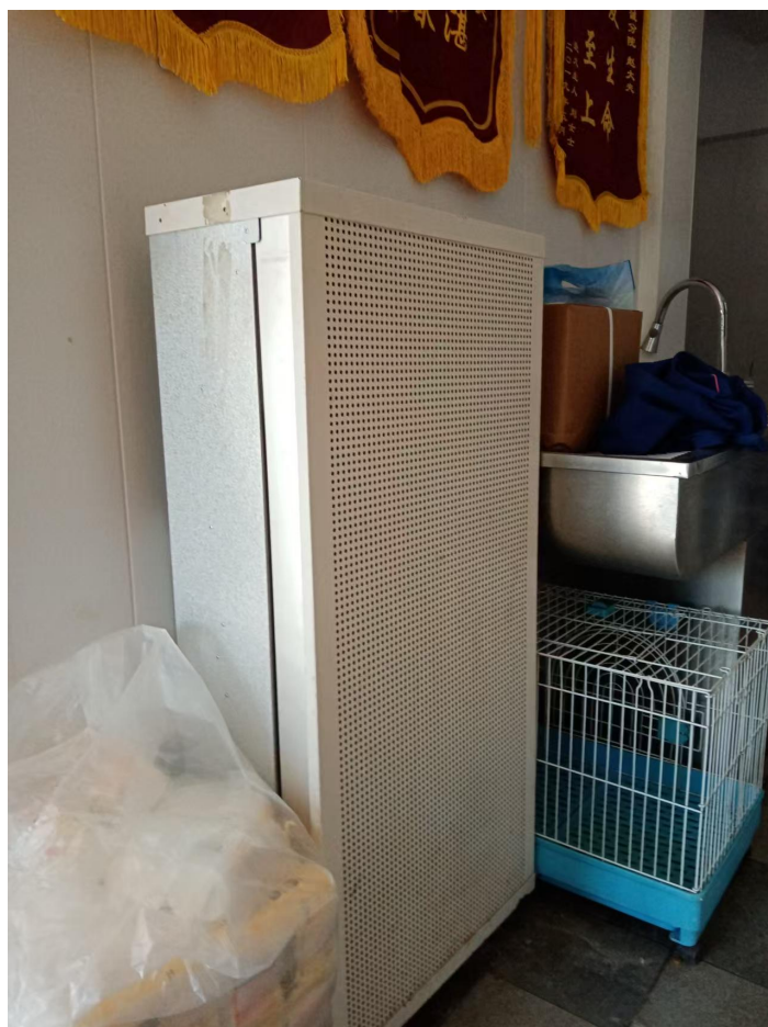
图 4-1 本项目安装的室内除臭用臭氧发生器
