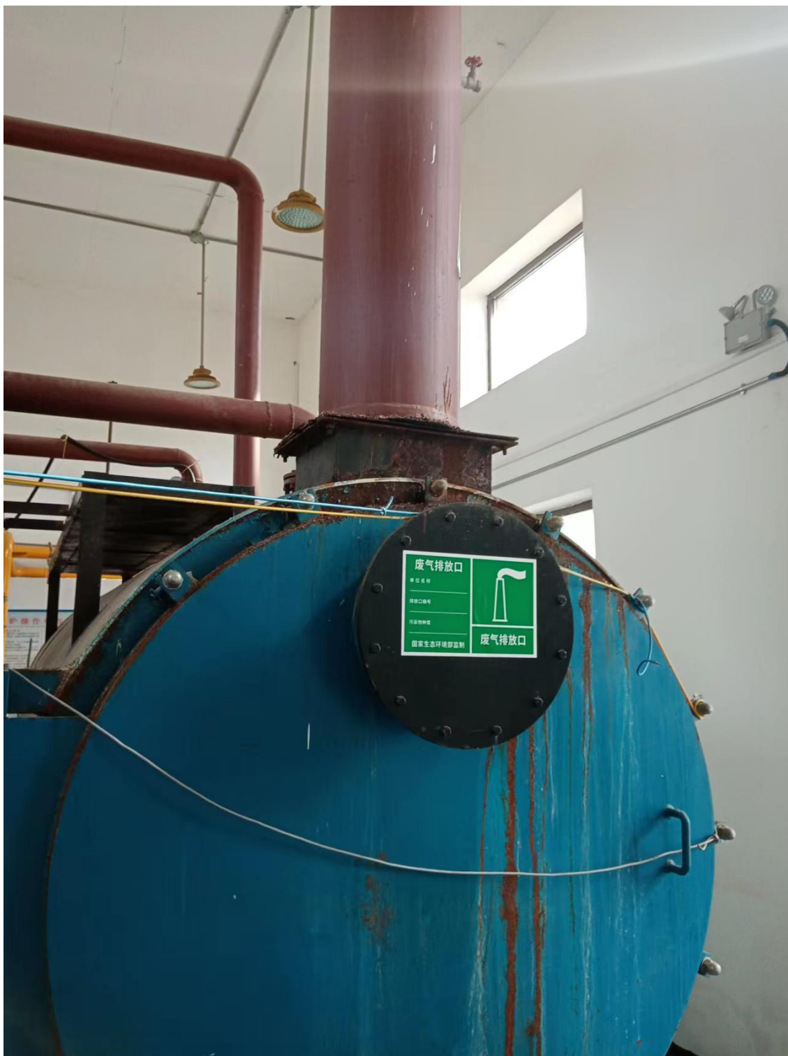
图4-2 本项目锅炉房烟囱现状
