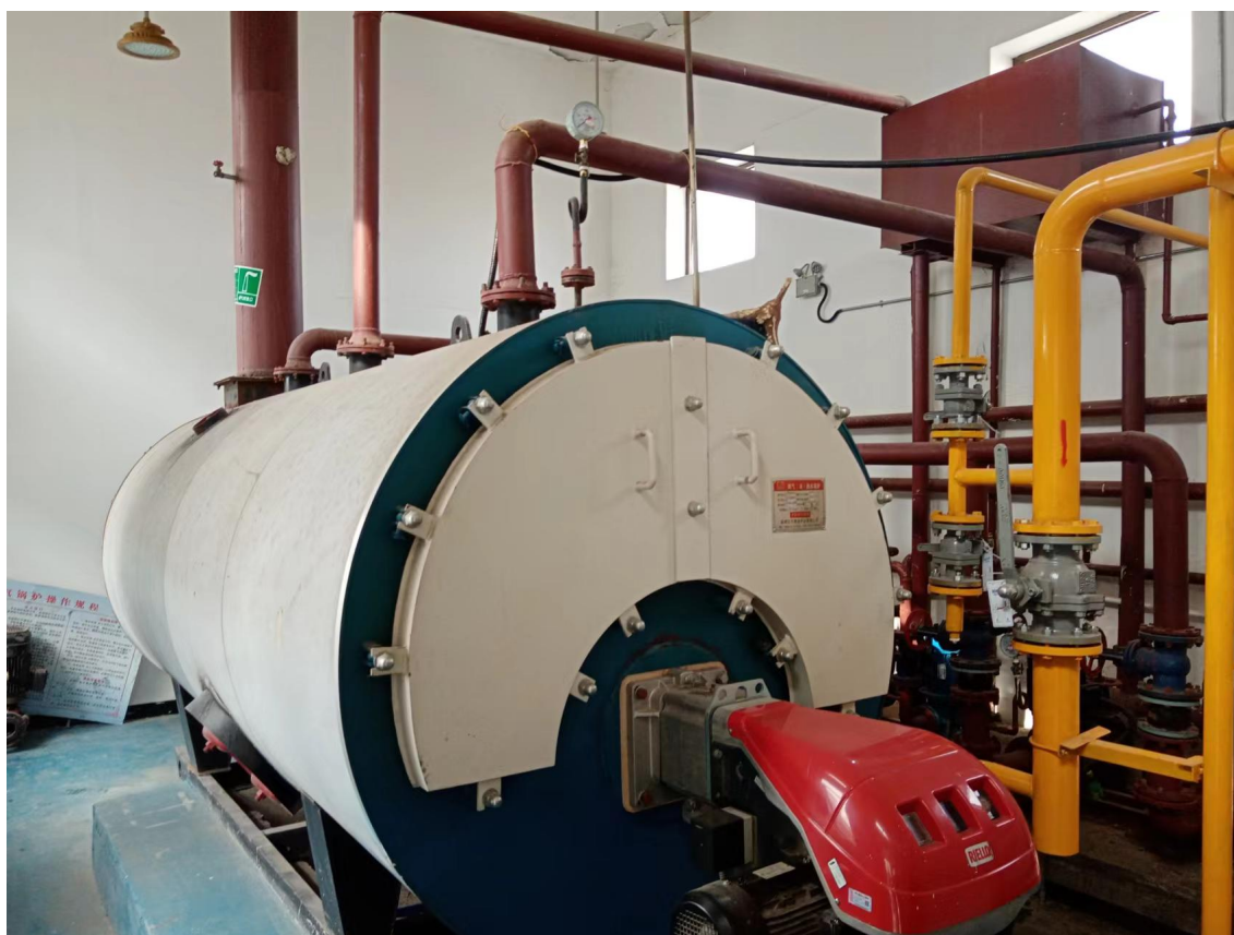
图 4-1 本项目锅炉房燃气锅炉现状
