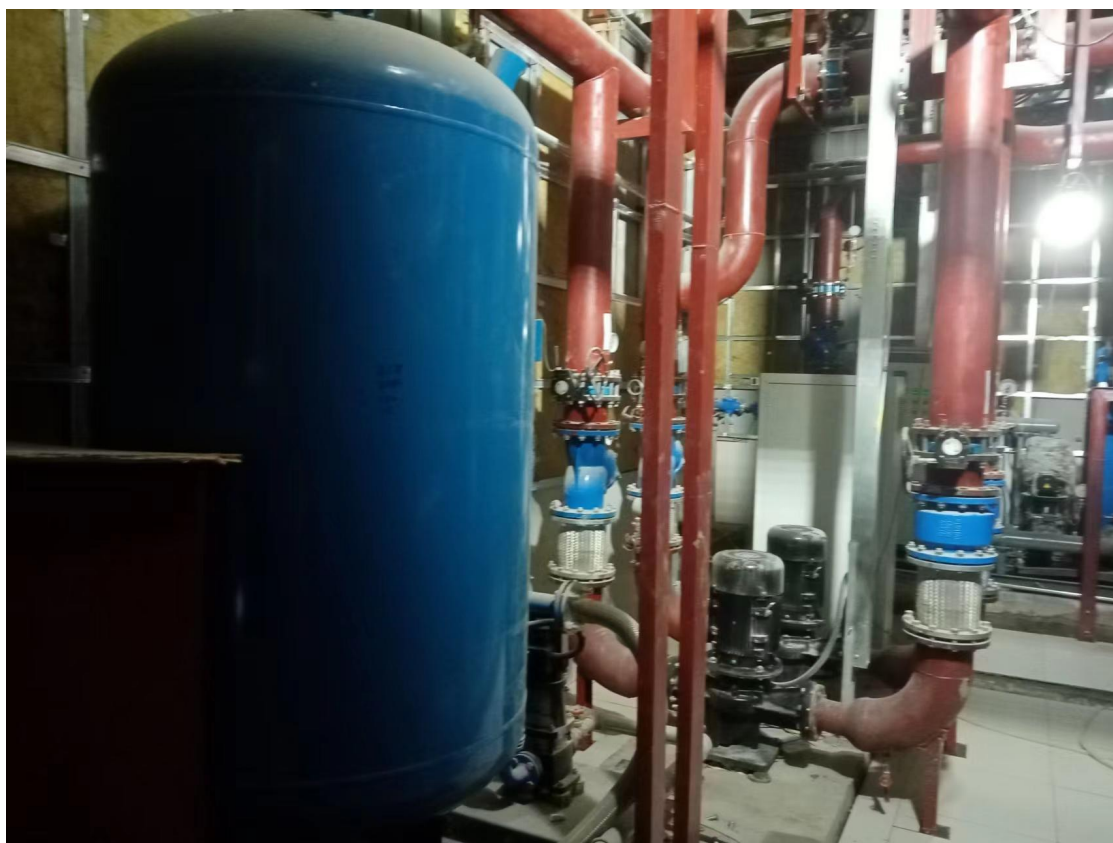
图 4-2 本项目锅炉房水泵间现状
