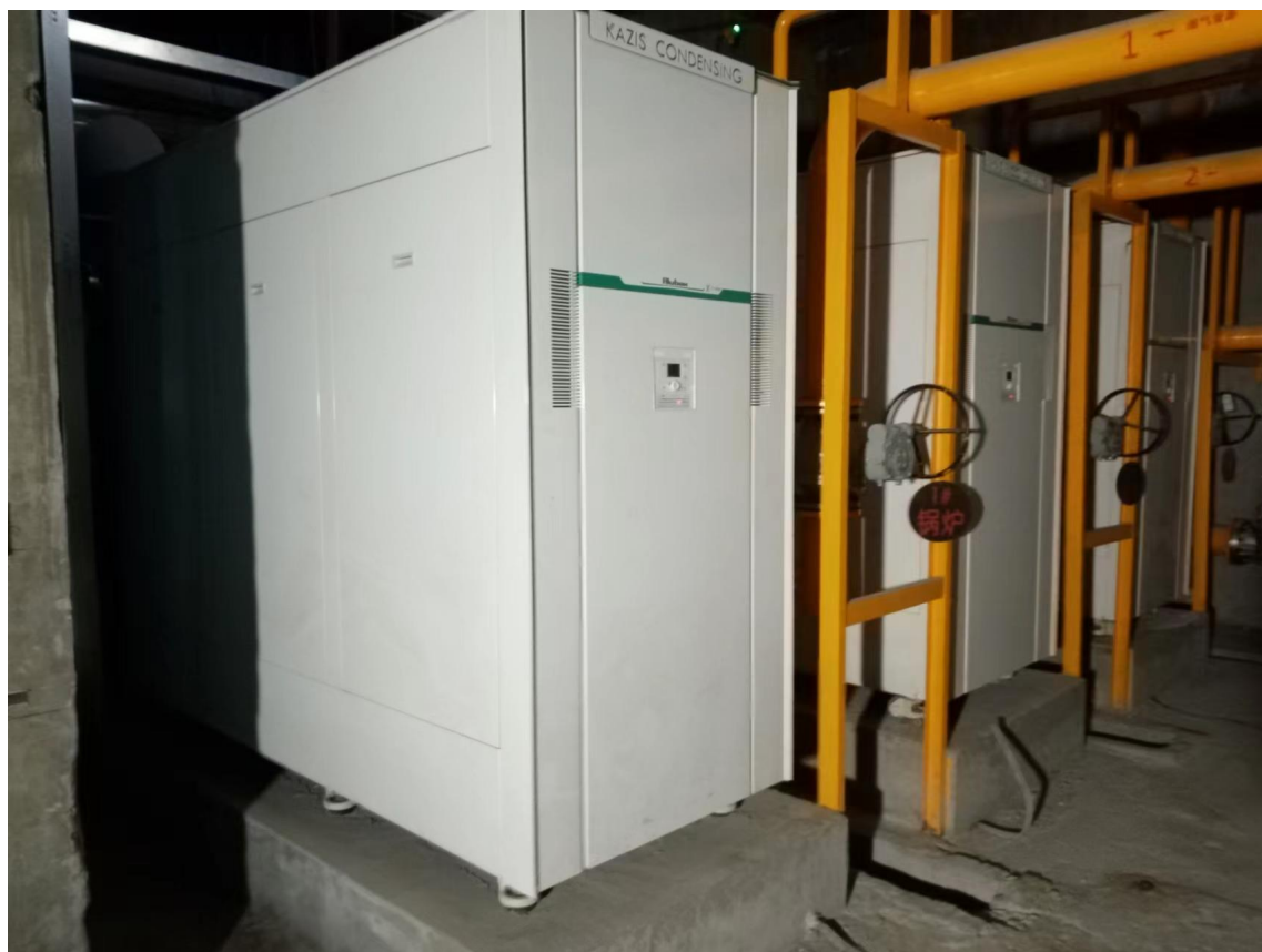
图 4-1 本项目锅炉房燃气锅炉现状
