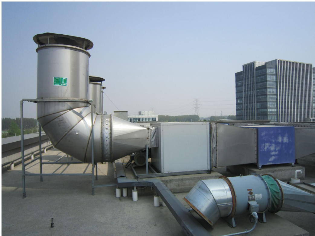
图 4-3 职工食堂油烟净化设施
