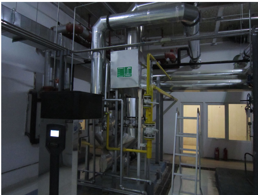
图 4-1 本项目燃气锅炉房设施及低氮燃烧器
