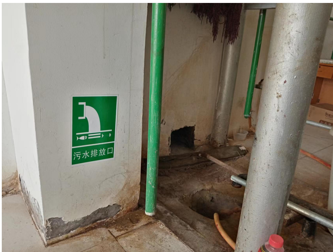
图4-2 本项目锅炉房废水排风口情况
