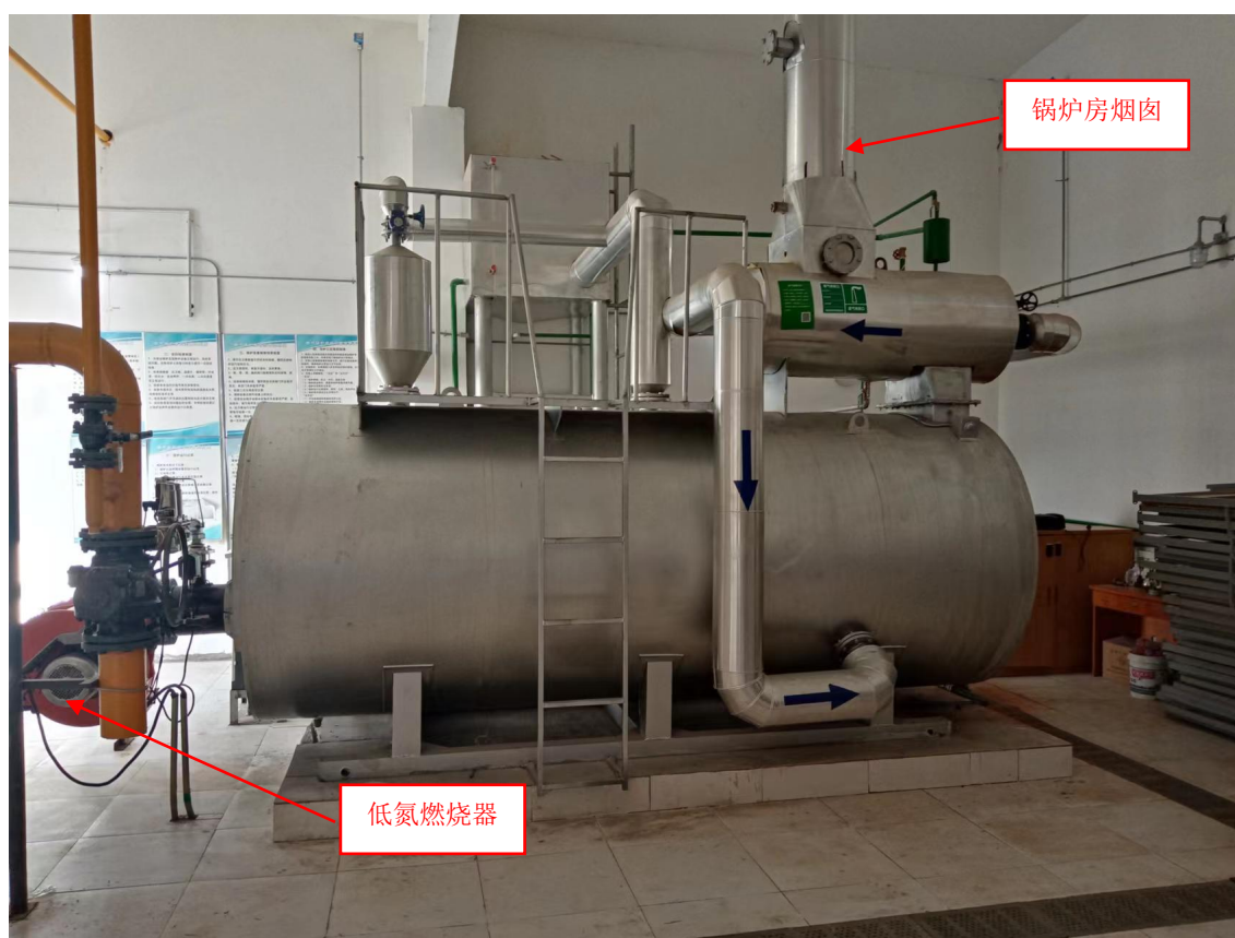
图 4-1 锅炉房设施及低氮燃烧器
