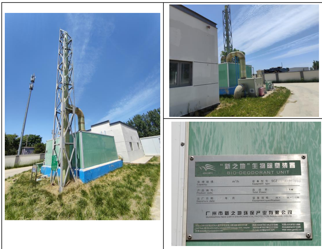
图 2-4 废气处理设施
