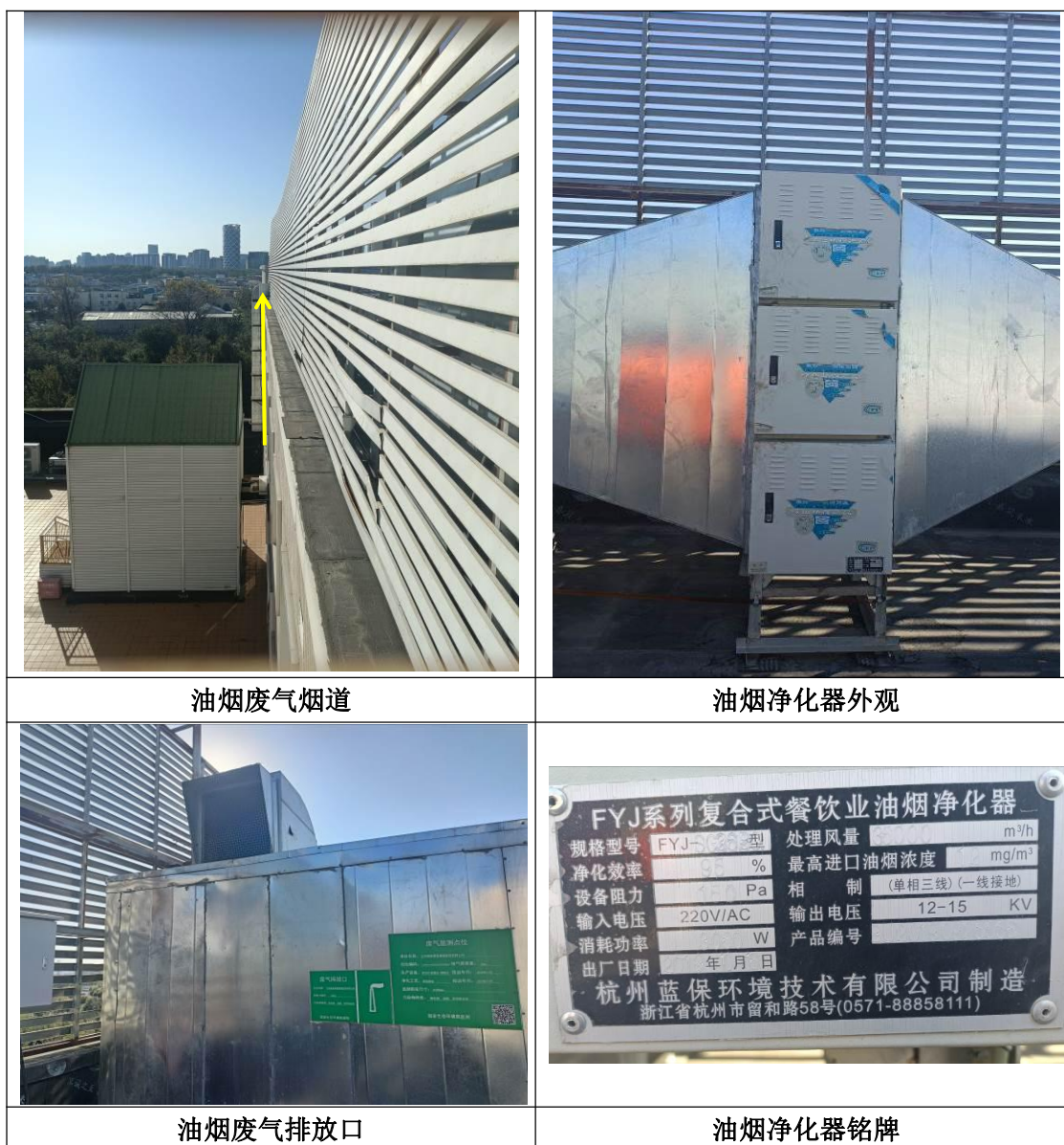
图7 食堂含油烟废气净化设施及排气筒照片
